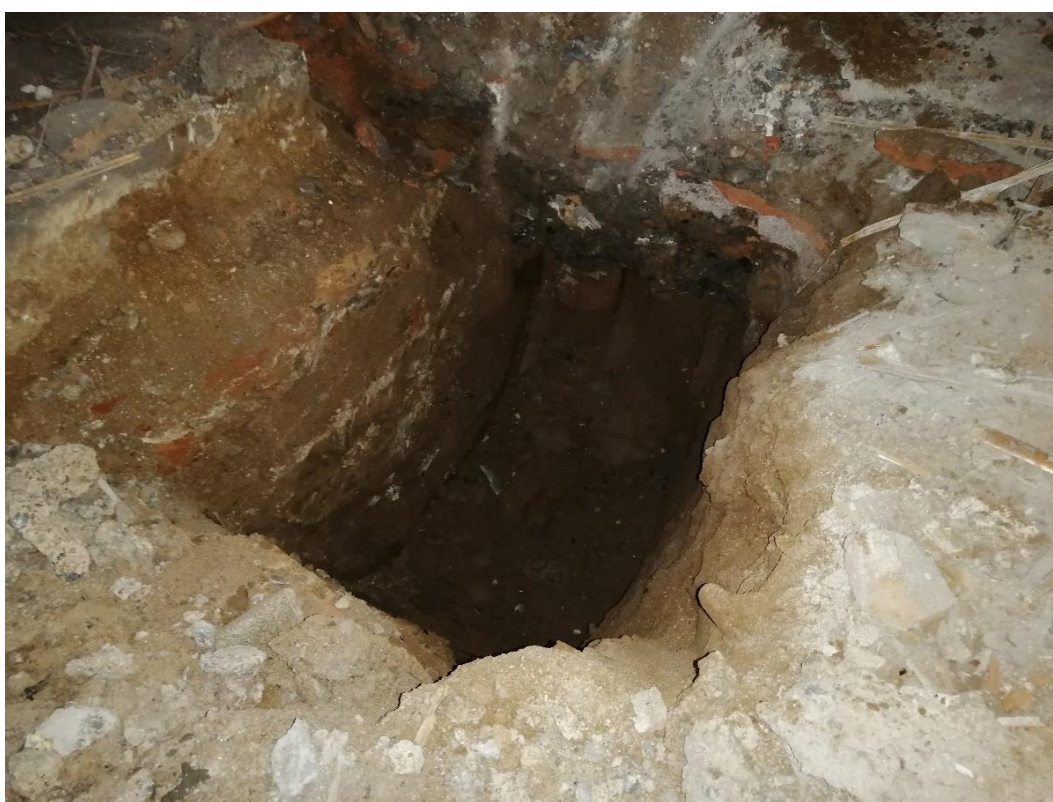
Fig.11. Fotografia final dels treballs de rebaix amb detall dels perfils 2 . Font: Imatge pròpia.
